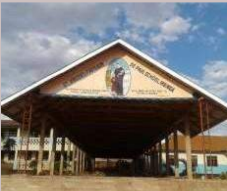
Tanzania: Construcción de un pabellón al aire libre en la escuela De Paul
